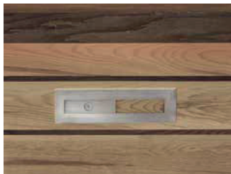
Camino per aerazione Ventilation grid
