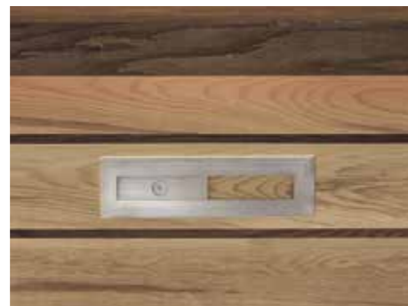
Camino per aerazione Ventilation grid
